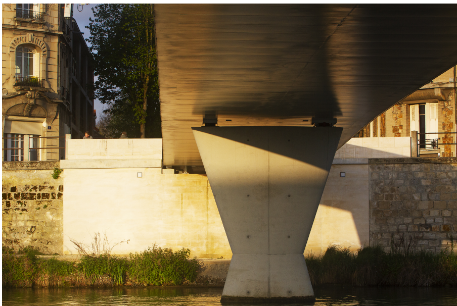
Détail d'un pilier supportant la passerelle des Anglais © Frédéric Sartiaux/Ville de Soissons
