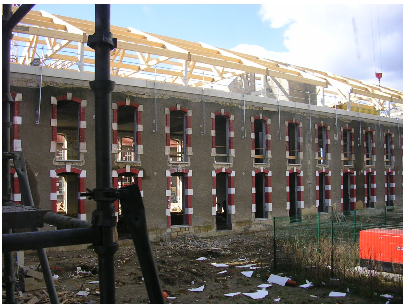
Début du chantier d'aménagement des casernements, exhaussement des bâtiments © Soissons Ville d'art et d'histoire
