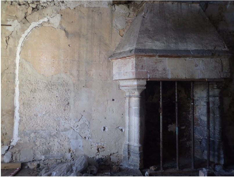
Vue sur la muraille du 3e siècle et le corps de logis nord PAH de Senlis à Ermenonville
