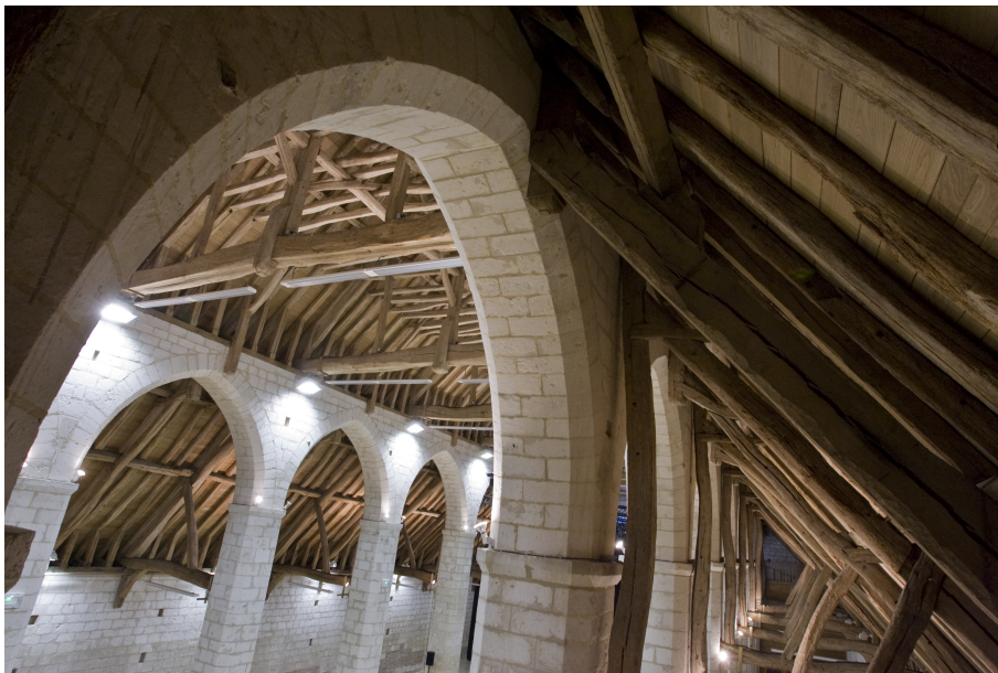
La charpente de la grange datée de 1219-1220 © Dir. de la communication, Ville de Beauvais
